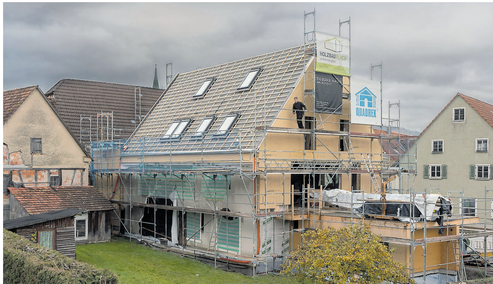
Wo einst die Entringer Pfarrer ihr Vieh hielten und die Vorräte lagerten, will künftig die Familie Walker mit drei kleinen Kindern leben und eine Zahnarztpraxis betreiben. Beim Umbau zum Wohn- und Geschäftshaus wird die Pfarrscheuer jetzt auch energetisch saniert. Bild: Ulrich Metz
